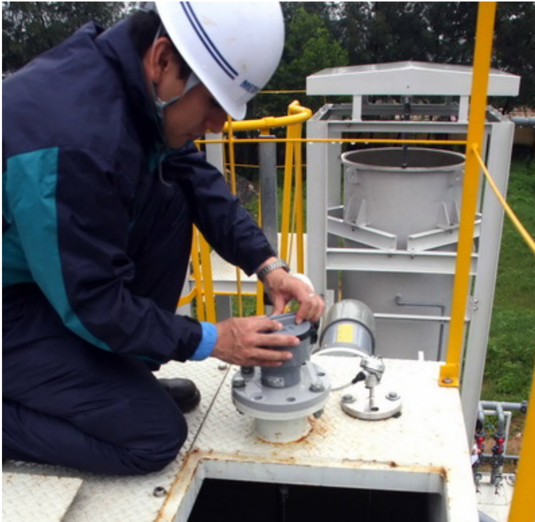
Chuyên gia Nhật Bản kiểm tra hệ thống xử lý nước thải và đưa vào hoạt động
